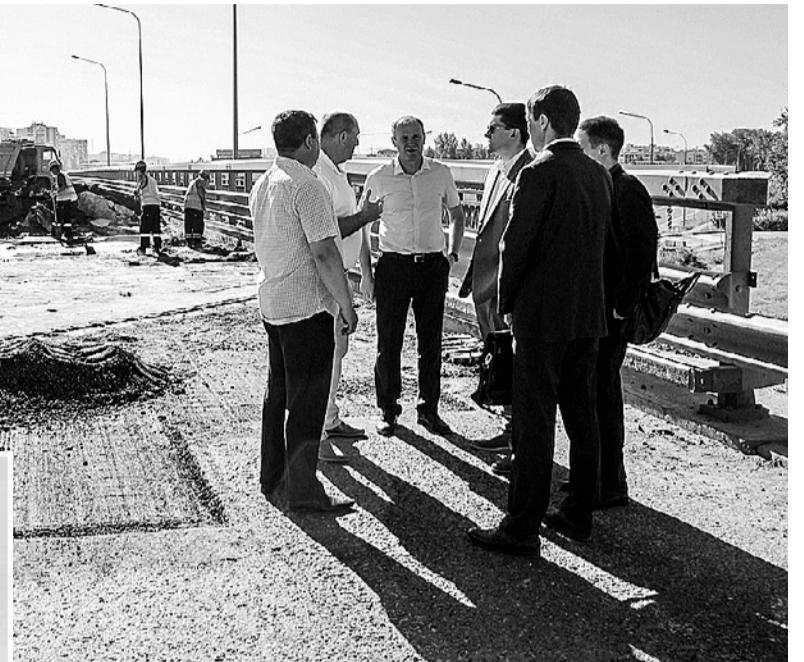
Ход работ на Червишевском тракте оценил начальник Главного управления строительства Тюменской области Павел Перевалов.
